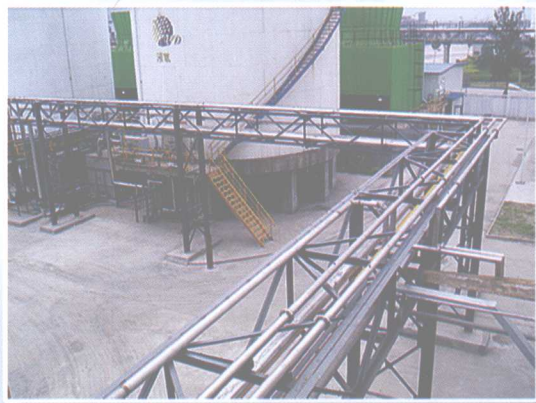
使用中的真空管道
