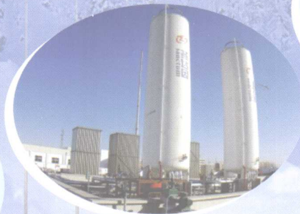
LNG应用工程
