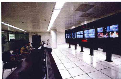
2007年地球站双星并发和转星工作以及配电系统改造等技术建设项目如期完成。在国家安全播出调度中心进行的业务抽查中，以总分54分的成绩在全国36个地球站中名列第一。
