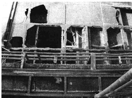
图 1.4-2 火灾外破损一角
