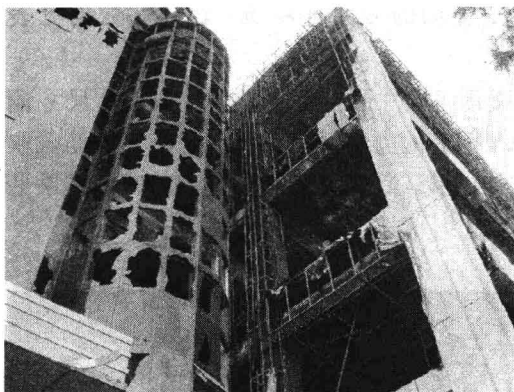
图 1.4-1 火灾外破损一角
