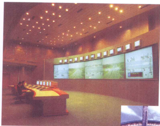
沪宁高速公路江苏段监控中心
