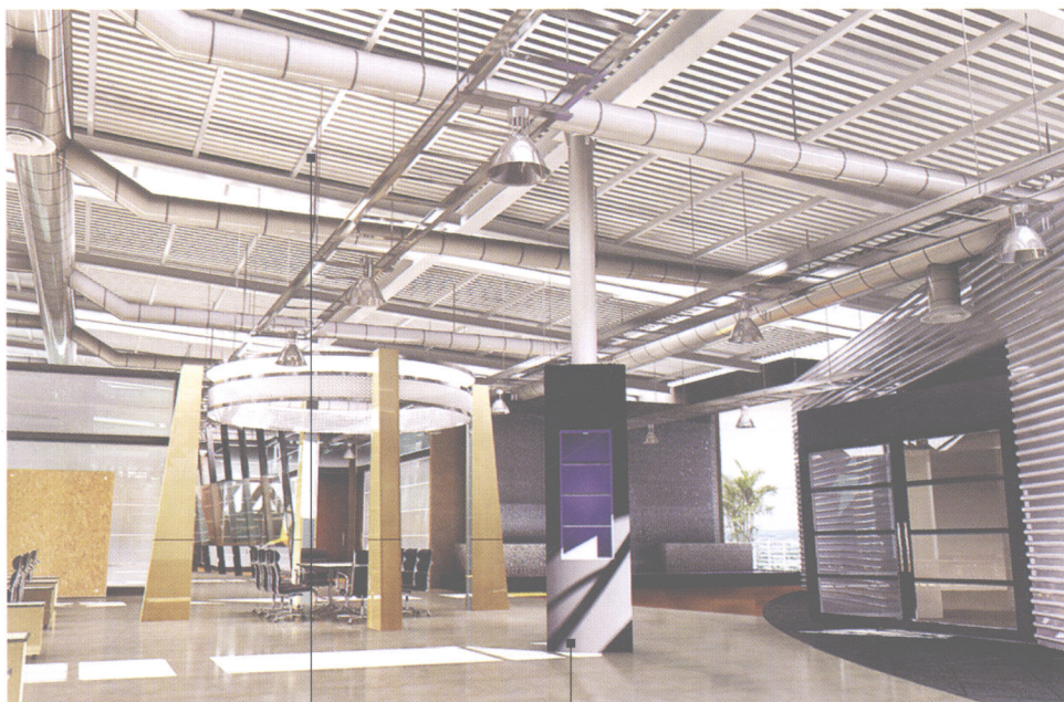
不锈钢管吊顶
