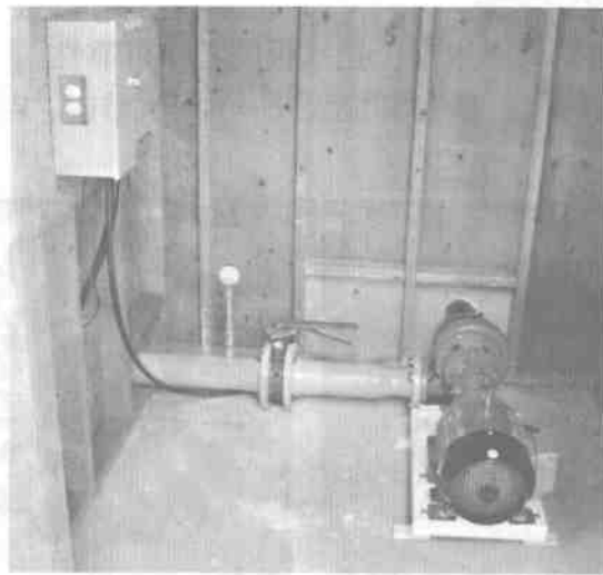
图 3-1 微水电发电站
