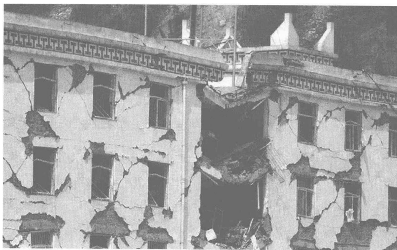
图 1-7 汶川大地震后破损的建筑
