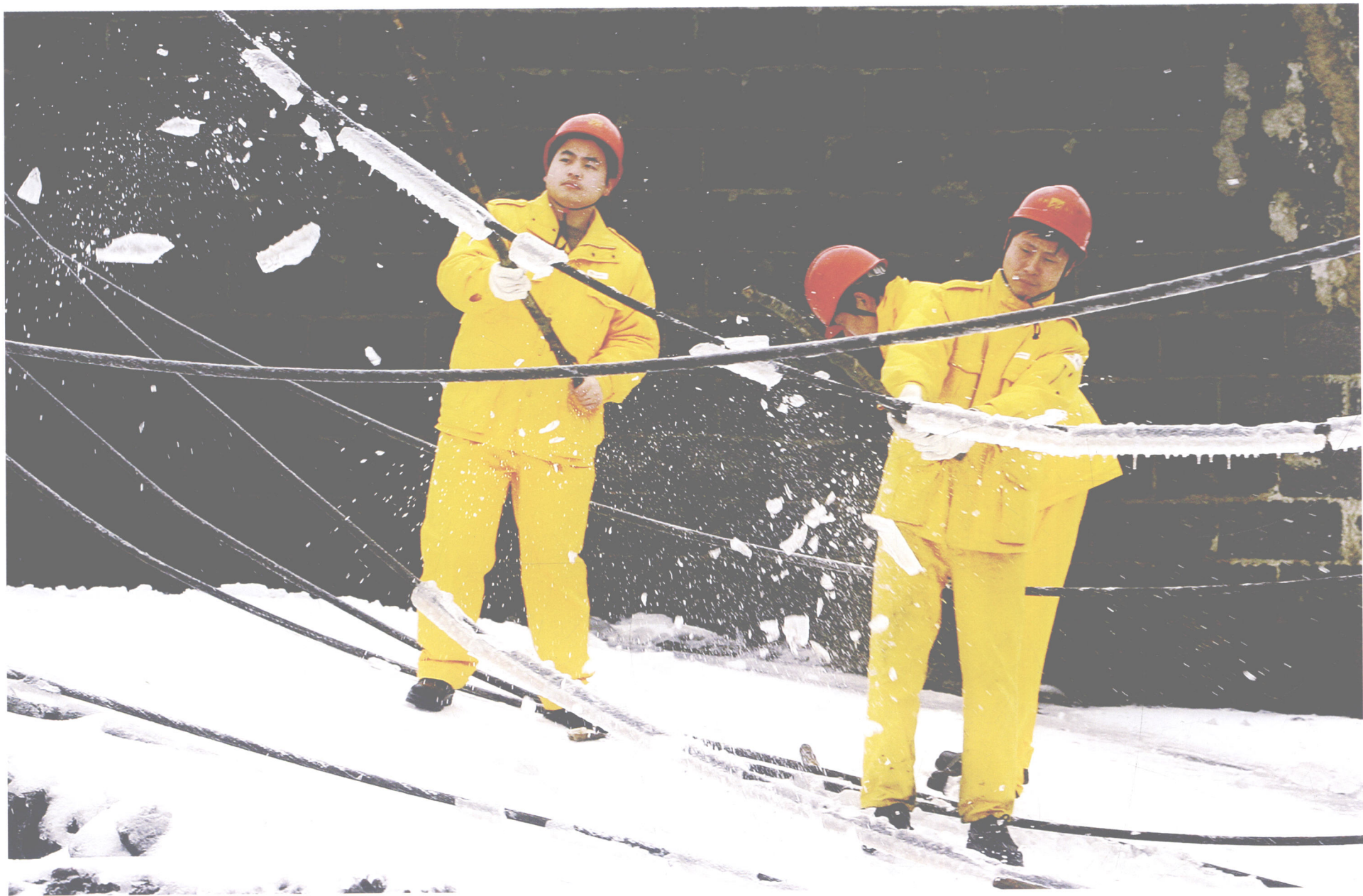
2008年2月2日，郴州。电力抢修人员正在用木棍敲碎电缆上的冰柱，以缓解电缆承受的压力。| 袁艺·摄 |
