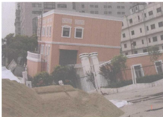
图2 房屋倾斜、下沉
