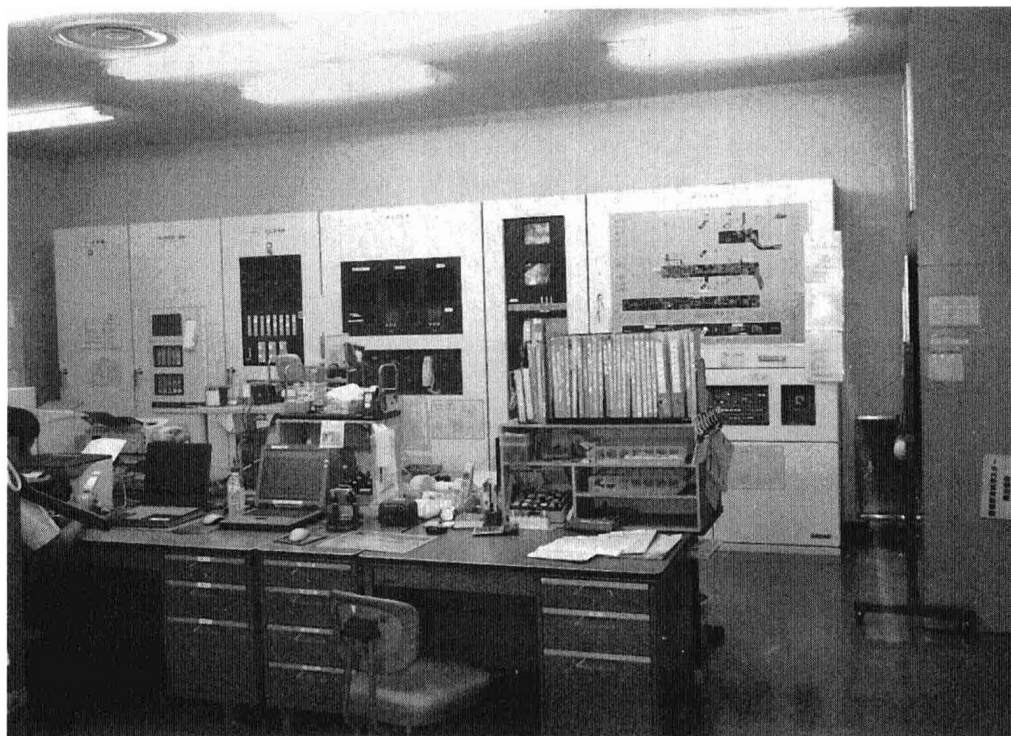
照片 29.10 将站务室作为防灾管理室示例
