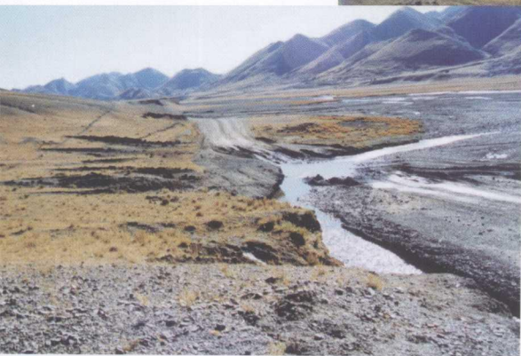
新藏公路 帮拉山以东地段有路无基
