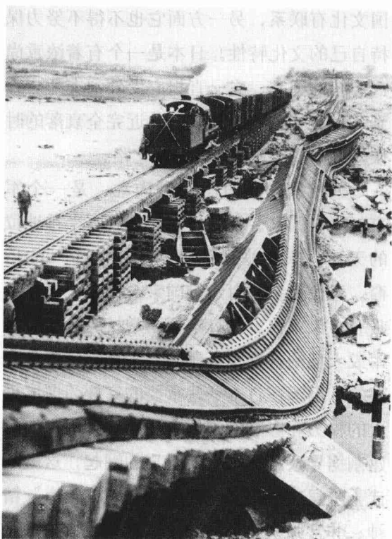
↑ 1939年被中国人炸掉的一段铁路，一列日本火车首次驶过重新修建的铁路。这段铁路在东北地区的沈阳市附近。
