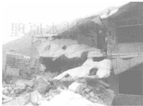
图 1-1 四川康定姑咱镇对面后山崩塌造成房屋毁坏的情况
