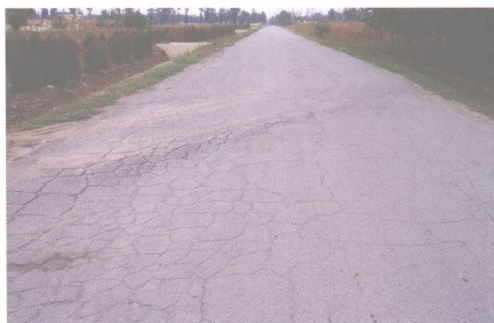
2007 年 10 月，顺义高丽营地区 地裂缝造成路面变形
