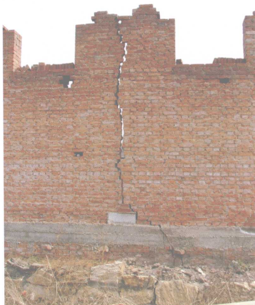
2002 年门头沟地区采空塌陷造成墙体开裂
