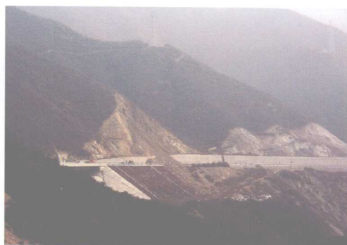
1999 年 11 月八达岭高速公路边坡崩塌灾害
