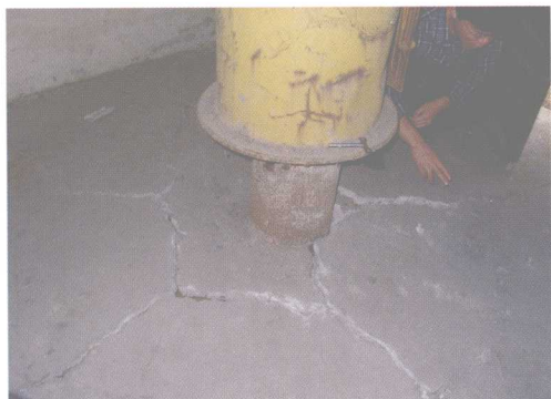
地面沉降造成某观测井井管 严重上升，地表开裂
