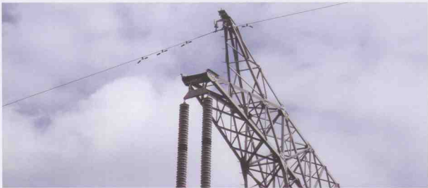
地线移位、防震锤变形情况
