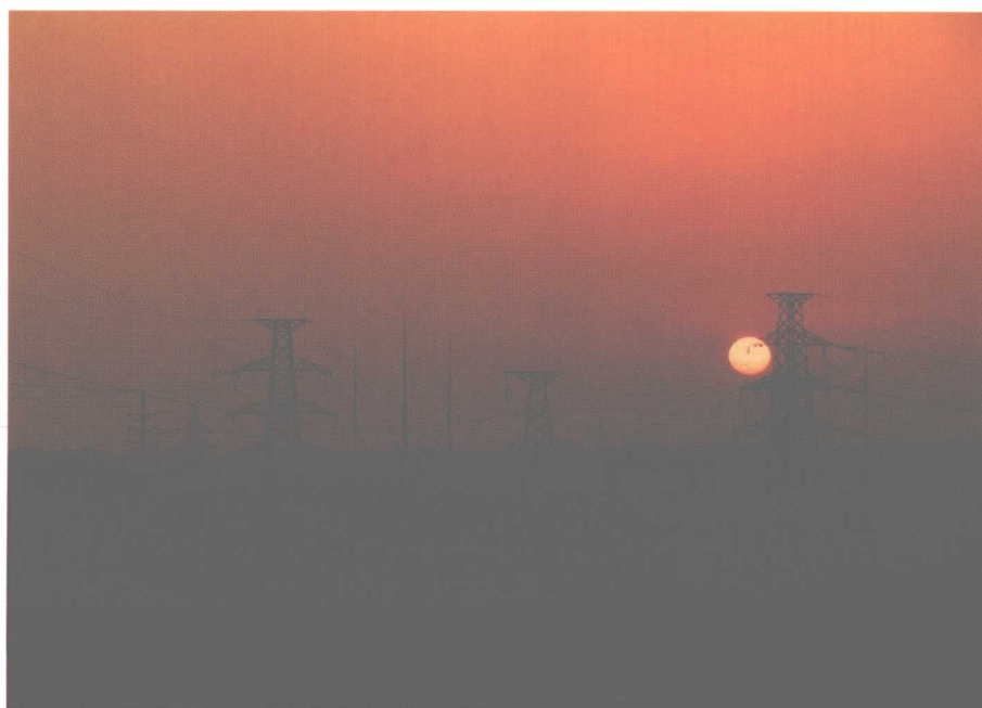
220 千伏 输电线路
