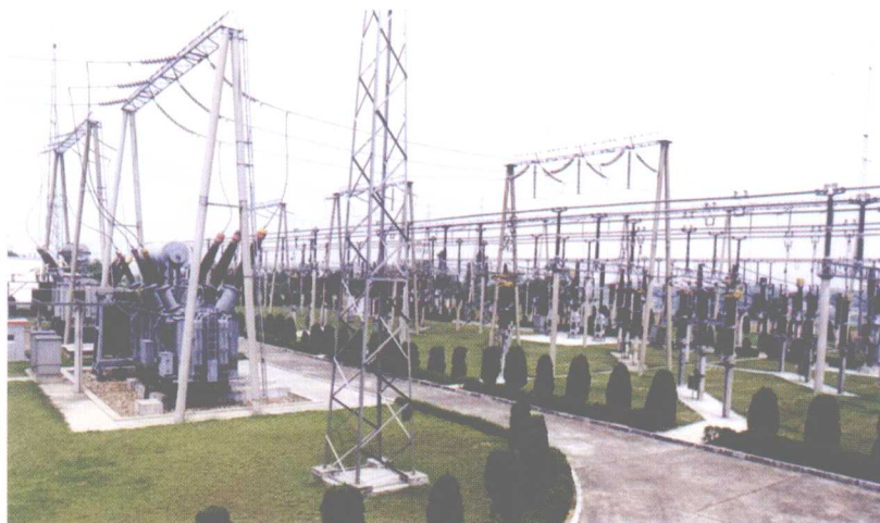
220 千伏池州变 电所内景
