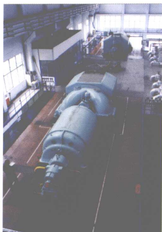
贵池发电厂 2.5 万千瓦 中温中压发电机组
