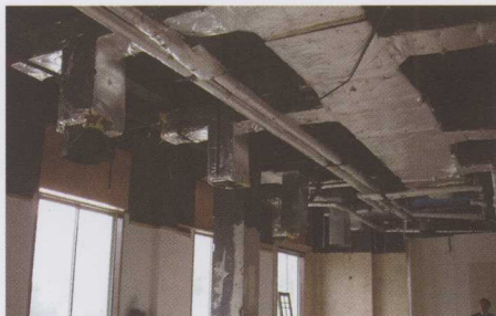
■ 图0-6 料理店现有空调及电路现状
