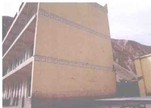
1.1.16 该教学楼山墙上的斜裂缝 (李力 摄)
