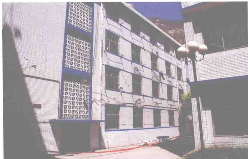
1.1.5 汶川威州某砖混结构教学楼纵墙上的交叉斜裂缝 (李力 摄)
