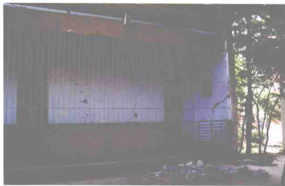
1.1.2 汶川威州某砖混结构宿舍纵墙和山墙上的斜裂缝（李力 摄）
