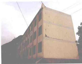
1.1.12 该教学楼山墙上的斜裂缝 (李力 摄)
