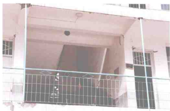
1.1.15 该教学楼楼梯间横墙开裂 (李力 摄)
