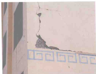
1.1.13 该教学楼山墙开裂情况 (李力 摄)
