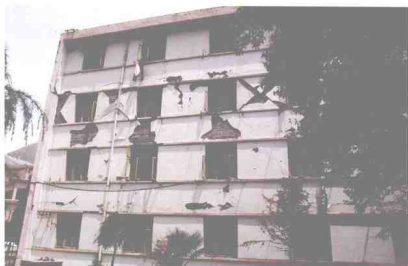
1.1.1 汶川威州某砖混结构宿舍窗间墙和窗台墙上的交叉斜裂缝（李力 摄）
