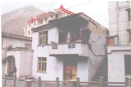
1.1.10 汶川威州某砖混结构住宅120厚砖墙剪切错动破坏 (李力 摄)
