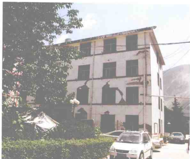
1.1.6 汶川威州某砖混结构窗间墙和窗台墙上的交叉斜裂缝 (李力 摄)
