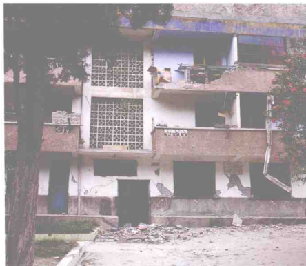
1.1.17 汶川威州某砌体结构住宅纵墙上的交叉斜裂缝和阳台栏板垮塌 (李力 摄)
