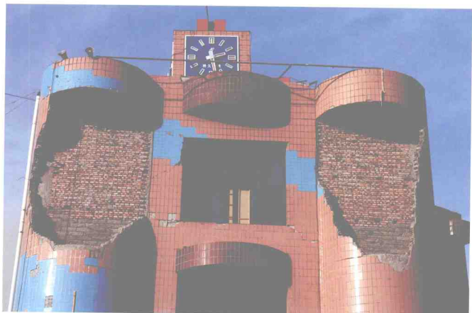
汶川威州某钟楼，时钟凝固在了2008年5月12日14时28分（李力 摄）
