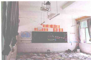
1.1.4 汶川威州某砖混结构教学楼横墙上的斜裂缝 (李力 摄)
