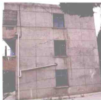
1.1.18 该住宅山墙上的交叉斜裂缝 (李力 摄)
