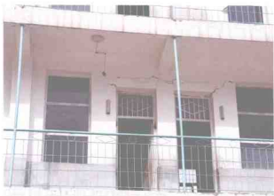
1.1.14 该教学楼门过梁破坏情况 (李力 摄)
