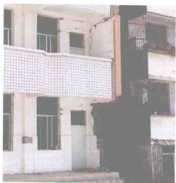
1.1.7 汶川威州某砖混结构外廊处山墙尽端无构造柱破坏情况 (李力 摄)
