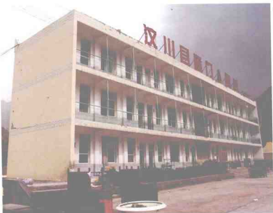
1.1.11 汶川雁门某混杂结构教学楼破坏严重 (李力 摄)
