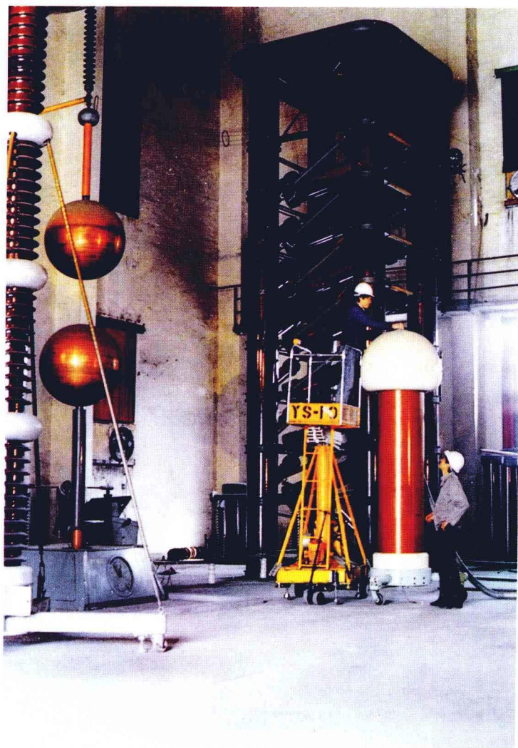
▲ 高压试验大厅一角
