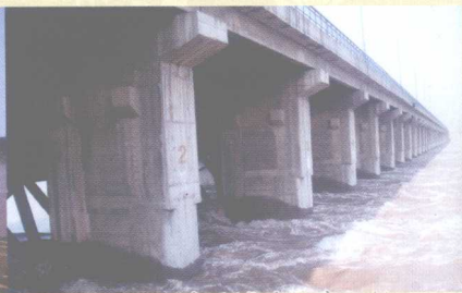
▲图为虎渡河北支上的荆江分洪闸(李春阳摄于2007年7月27日)
