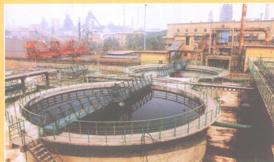
污水处理净化池
