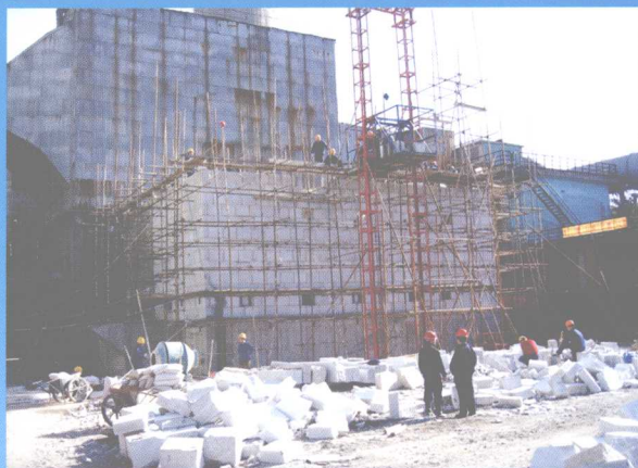
发电厂麻石水浴脱硫项目
