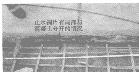
图7 天生桥面板沿垂直缝 L3/L4 崩角压损
