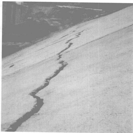
图 6 天生桥一级垫层料裂缝情况
