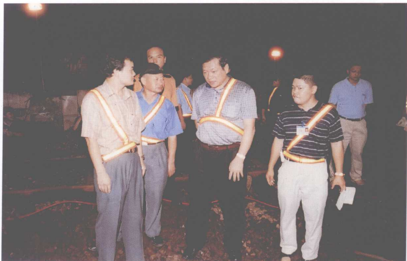
2003年8月20日深夜,罗湖新桥第一次线路大拨接揭开战幕。图为时任广深股份公司总经理冯启富(前排中,现任京津交通工程有限公司总经理)在广深土木工程公司总经理林良荣(左)的陪同下,在大拨接工地检查工作。
