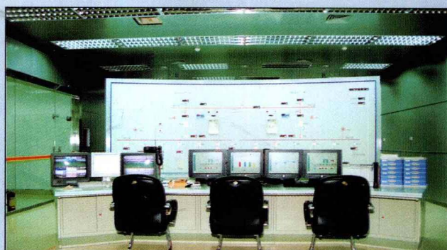
莲湖泵站中控室
