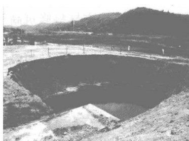
d) 路基塌陷
