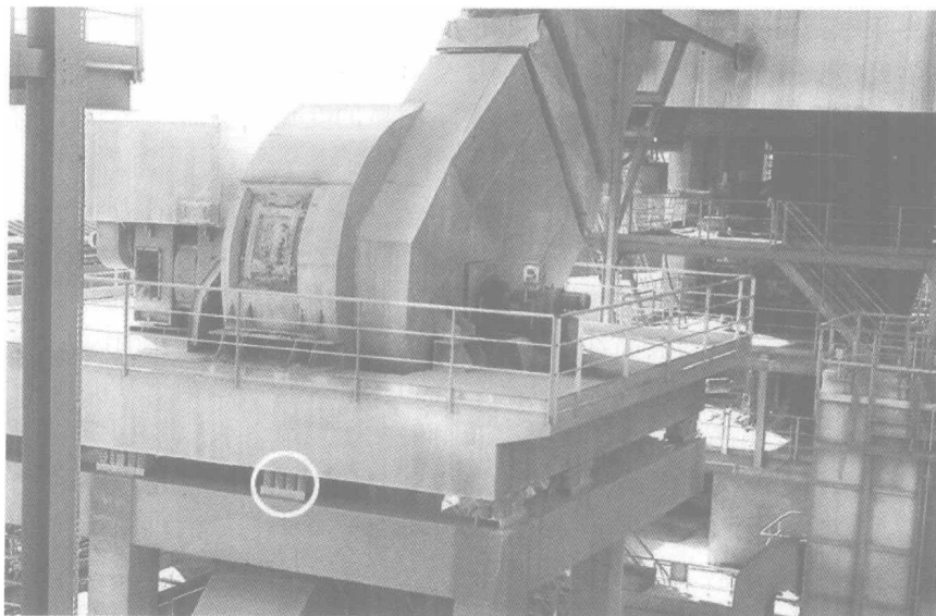
图 1-1-2 放置于高架结构的风机采用弹性隔振基础
