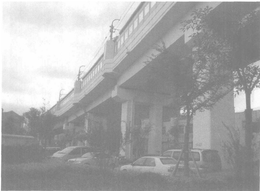
图 1-1-9 上海地铁四川路高架桥上采用钢弹簧浮置板技术取得卓越减振降噪效果
