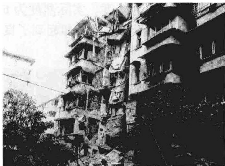
图 1.12 不设构造柱圈梁的砌体结构局部倒塌 (7/8~9)
