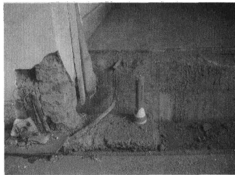
图 1.26 相邻厂房地面沉降差约 30cm (7/8~9)
