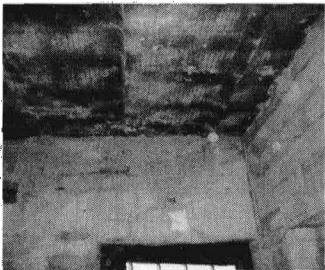
图 1.7 彭州市剪力墙结构高连梁破坏 (7/7 照片由李学兰提供)
