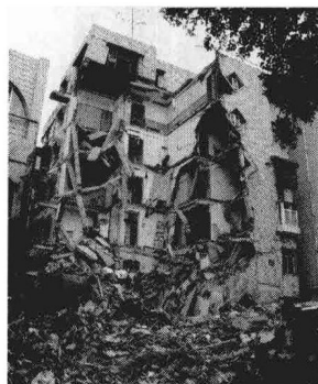
图 1.14 承重墙破坏 导致预制板塌落 (7/8~9)
