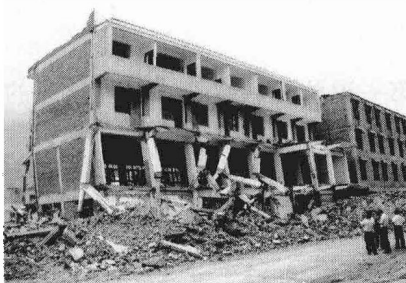
图 1.10 平武南坝镇相邻的医院和住宅楼 (7/9)
