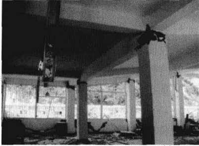
图 1.5 濠口中学框架结构柱铰机制破坏 (7/11)
