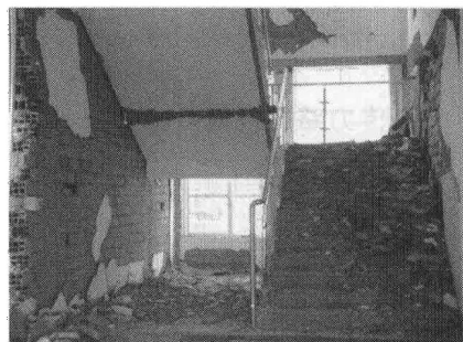
图 1.18 都江堰中学教学楼 楼梯间破坏 (7-1/8~9)
