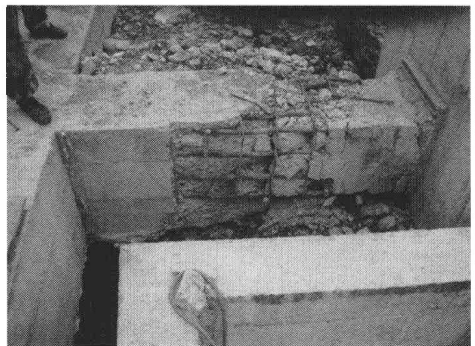
图 1.32 设备基础承台梁剪断 (7/8~9)
