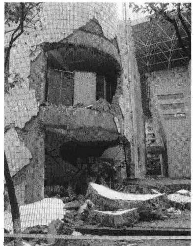
图 1.22 东汽小学框架结构 转角填充墙破坏 (7/8)
