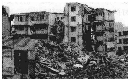
图 1.13 预制空心板滑动塌落 (7/8~9) (照片由裴友法提供)
