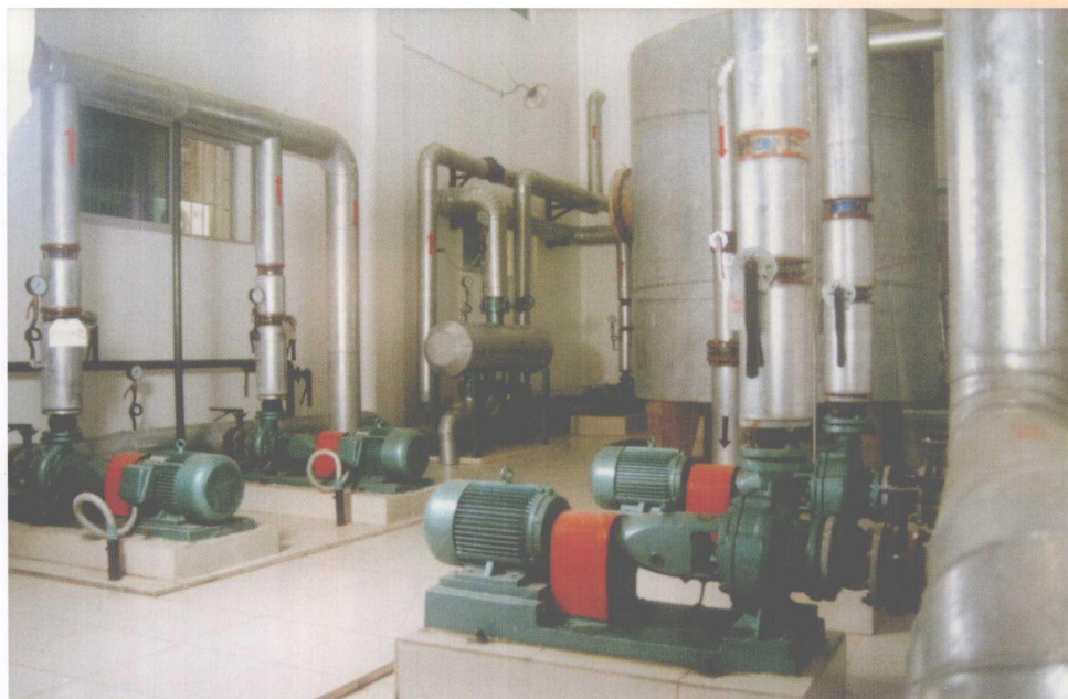
▲ 地热供热系统
