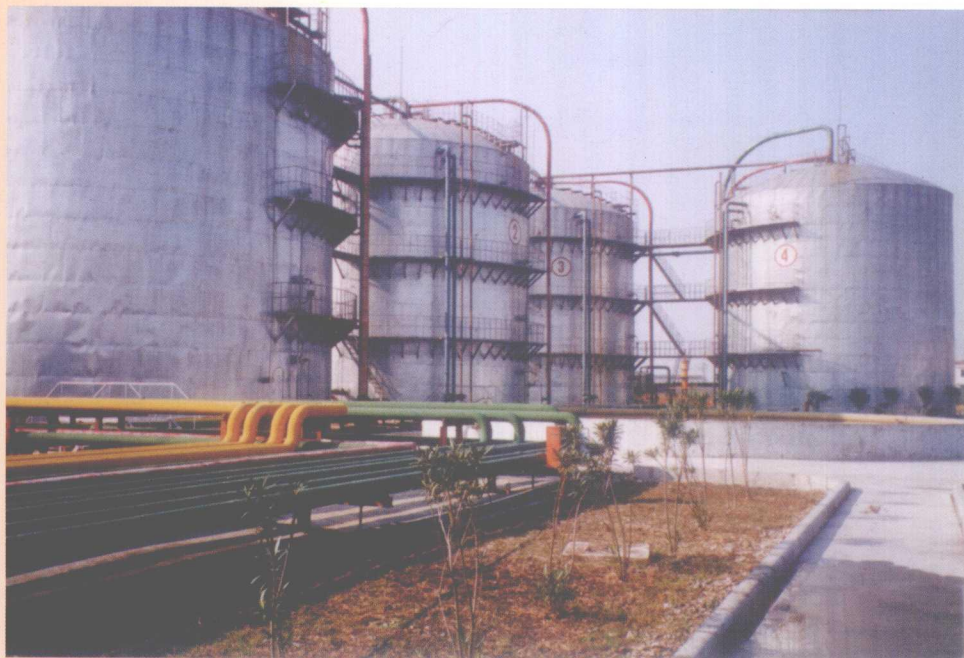
▲ 太仓酿酒厂厌氧处理木薯干酒精废液工程
