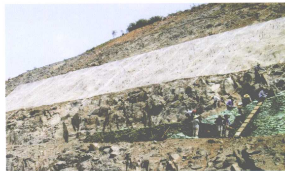
图1-3 开挖公路造成东庐山岩性陡坡
