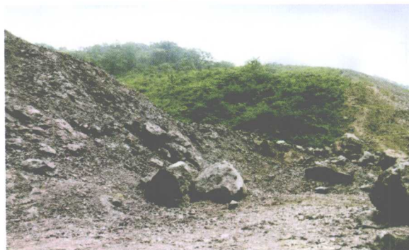
图1-2 开挖公路破坏地形地貌
