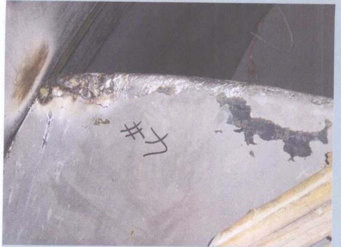
转桨式水轮机叶片磨蚀情况（三门峡水电站）
