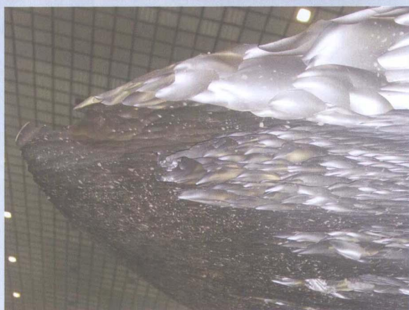
转桨式水轮机叶片进水边背面破坏情况（葛洲坝水电站）
