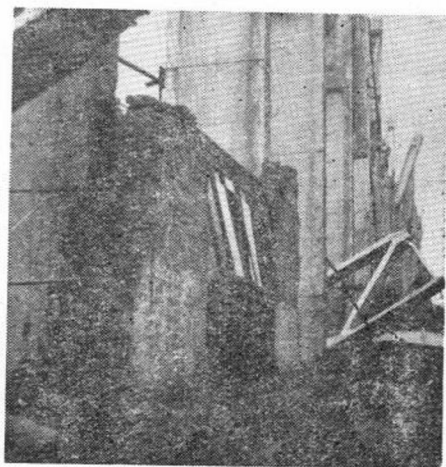
图6 唐山水泥机械厂厂房倒塌后柱基和条基的变形情况
