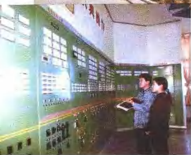
玛一奎电网控制室
