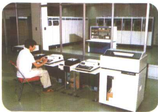
北京东单电话局的程 控交换机房。
