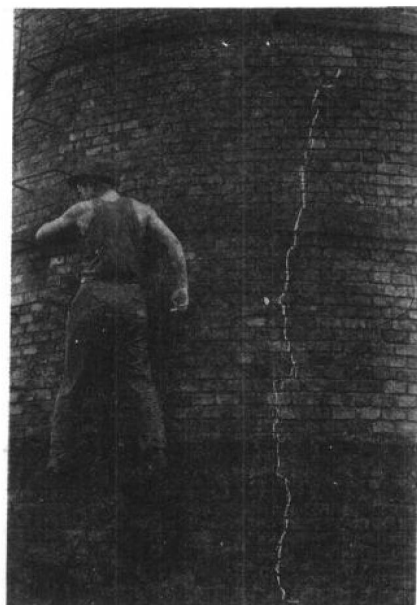
图 0.4 南昌钢铁厂烟囱开裂
