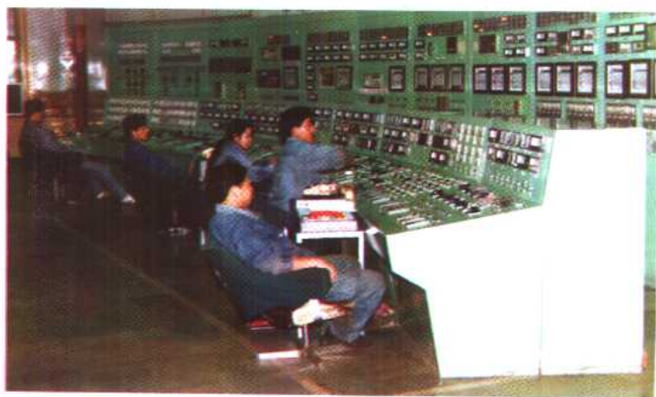
单元机组控制室
