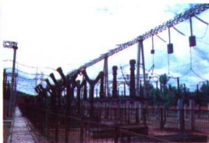
△ 谢家河输变电站
