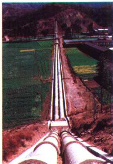
◁ 农田输水管道
