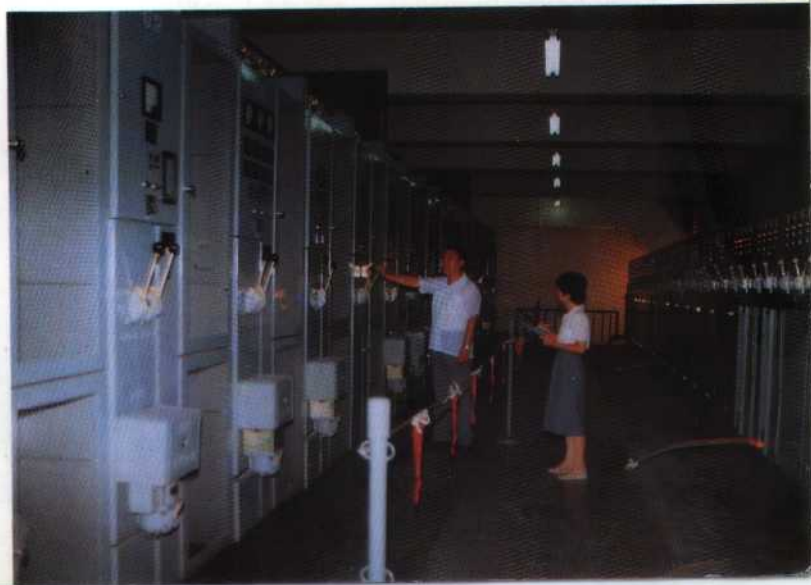
▷ 庞大设备系统组成的“内部世界”之一角。
