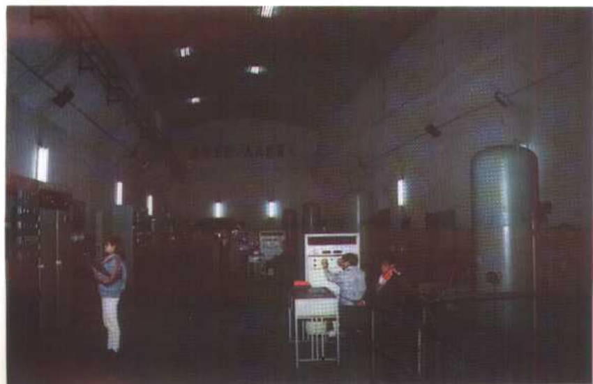
◀ 渠县南阳滩水电站主厂房
