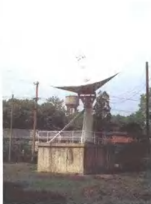
国务院赠送给老区的第一座 地面卫星站在江西建成开通
