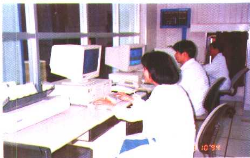
◀ 万门程控电话机房一角
