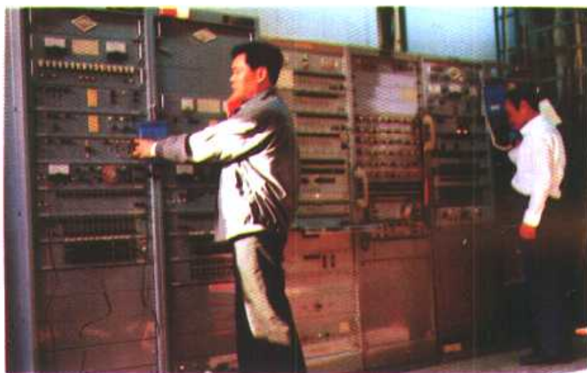
▶ 长途传输机房一角
