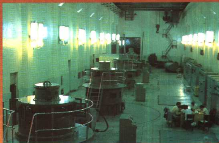
四川省第二大水电站——映秀湾发电厂 一级电站地下厂房
