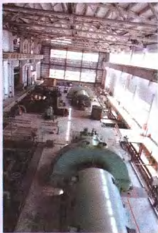
馬村電廠發電機組
