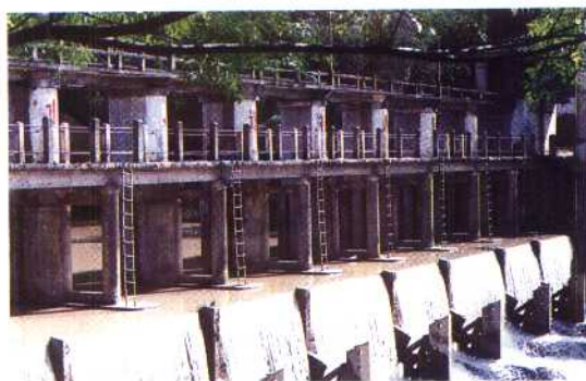
引泗工程 设计引水流量 4.5 \times 10^4 立方米/秒, 灌溉五万余亩农田。图为改造后的水力自控翻板闸拦河坝。
