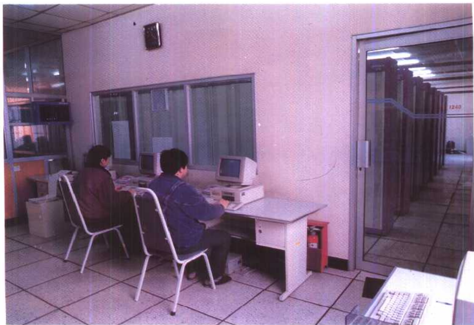
扬州市邮电局 程控交换机房
