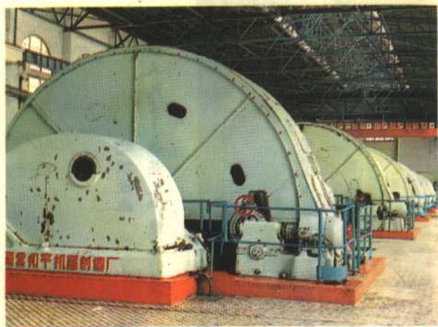
质量第一——127厂1958年生产的1 T266 空气压缩机群 目前仍在吉林化肥厂正常运转
