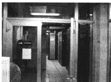
图 1-10 曙光 4000A 机房入口
