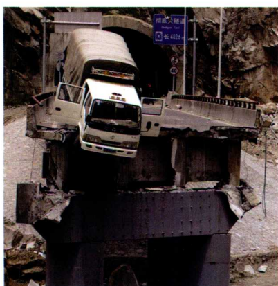
桥断了，车悬一线！
