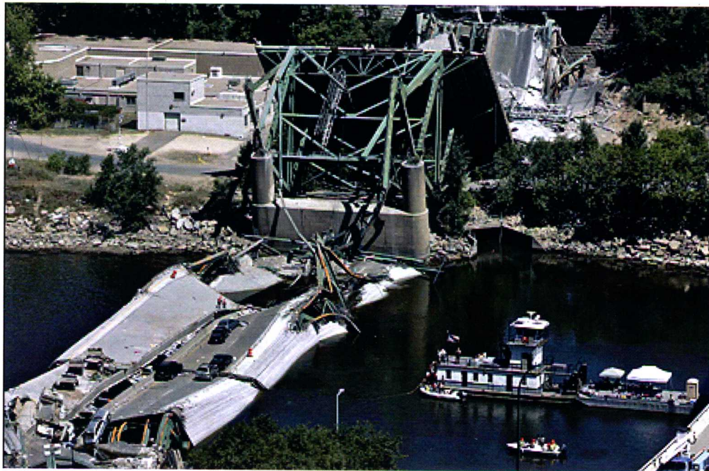
美国明尼阿波利斯桥倒塌 (Minneapolis Bridge Collapse)
