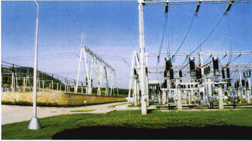
遵化店镇韩庄变电站
