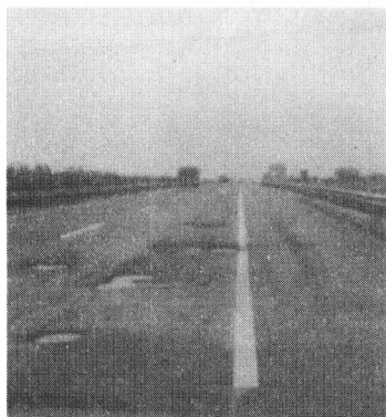
图 1-10 沥青路面的坑洞
